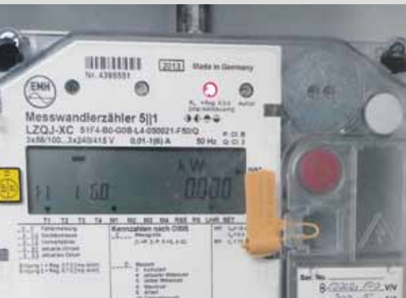
Fernauslesbare Zähler sind zentraler Bestandteil eines Energiemesssystems.
