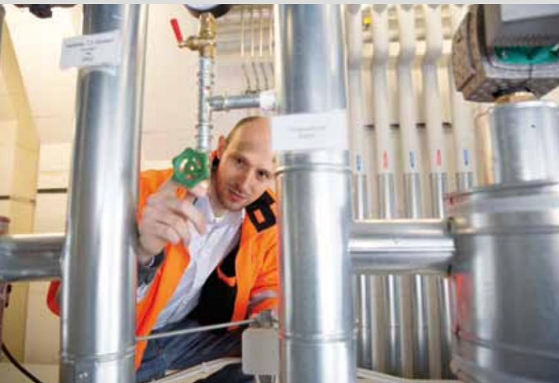
Detektivische Fähigkeiten sind notwendig, um Energieeinsparpotenziale aufzudecken.
