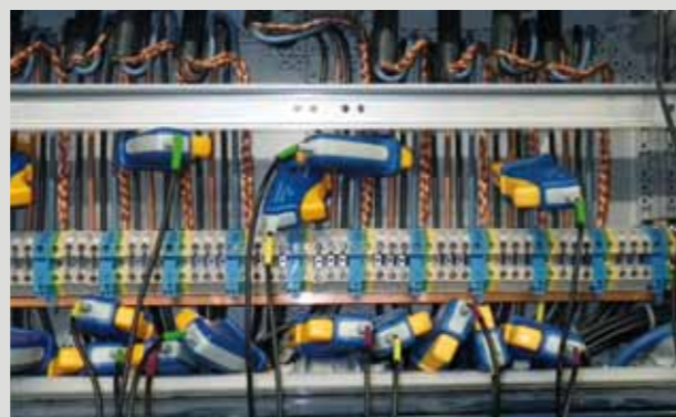
Das Wissen über den aktuellen Verbrauch ist der Schlüssel zu potenziellen Schwachstellen.
